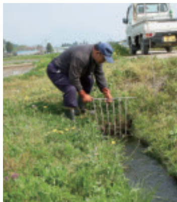
▲用水路に除じんスクリーンを設置しているようす
